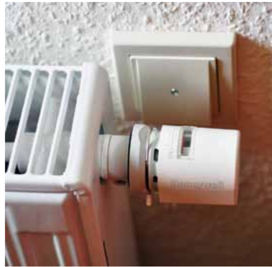
Honeywell-Stellantrieb an den Radiatoren in den Wohnräumen
